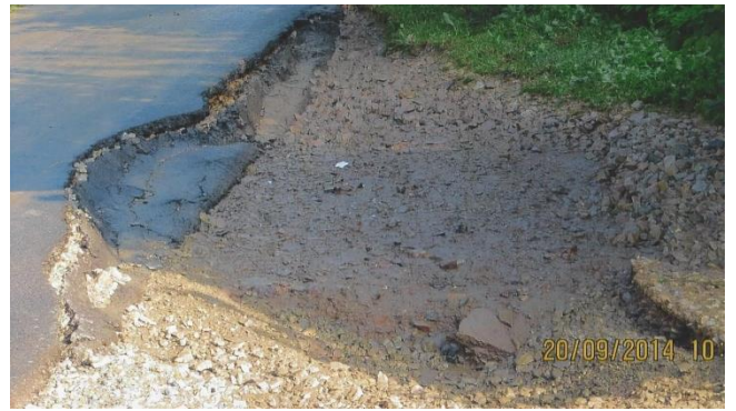
2: Abgebrochener Wegrand durch Ausspülung
