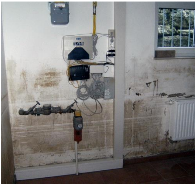
3: Schäden an der Elektrik und Heizungen
