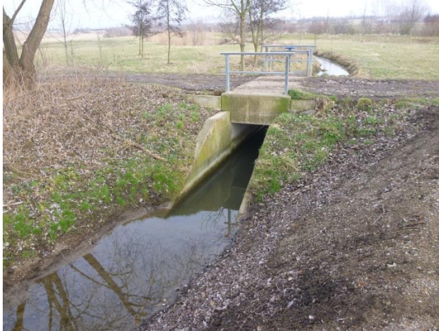
1: Sieibauwerk, Zufluss aus dem GVZ
