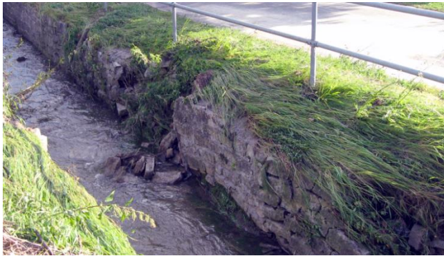
1: Ausgespülte Steine im Böschungsbereich
